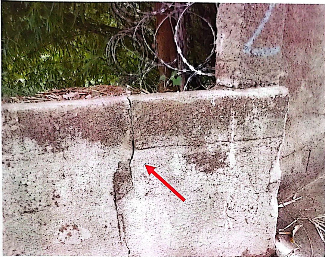
FOTO 07 – Presença de fendas na mureta da Rua da Charqueada.
