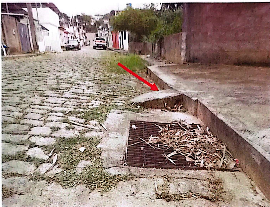
FOTO 03 – Rampa de concreto e folhas secas impedindo o livre escoamento das águas pluviais até o bueiro.
