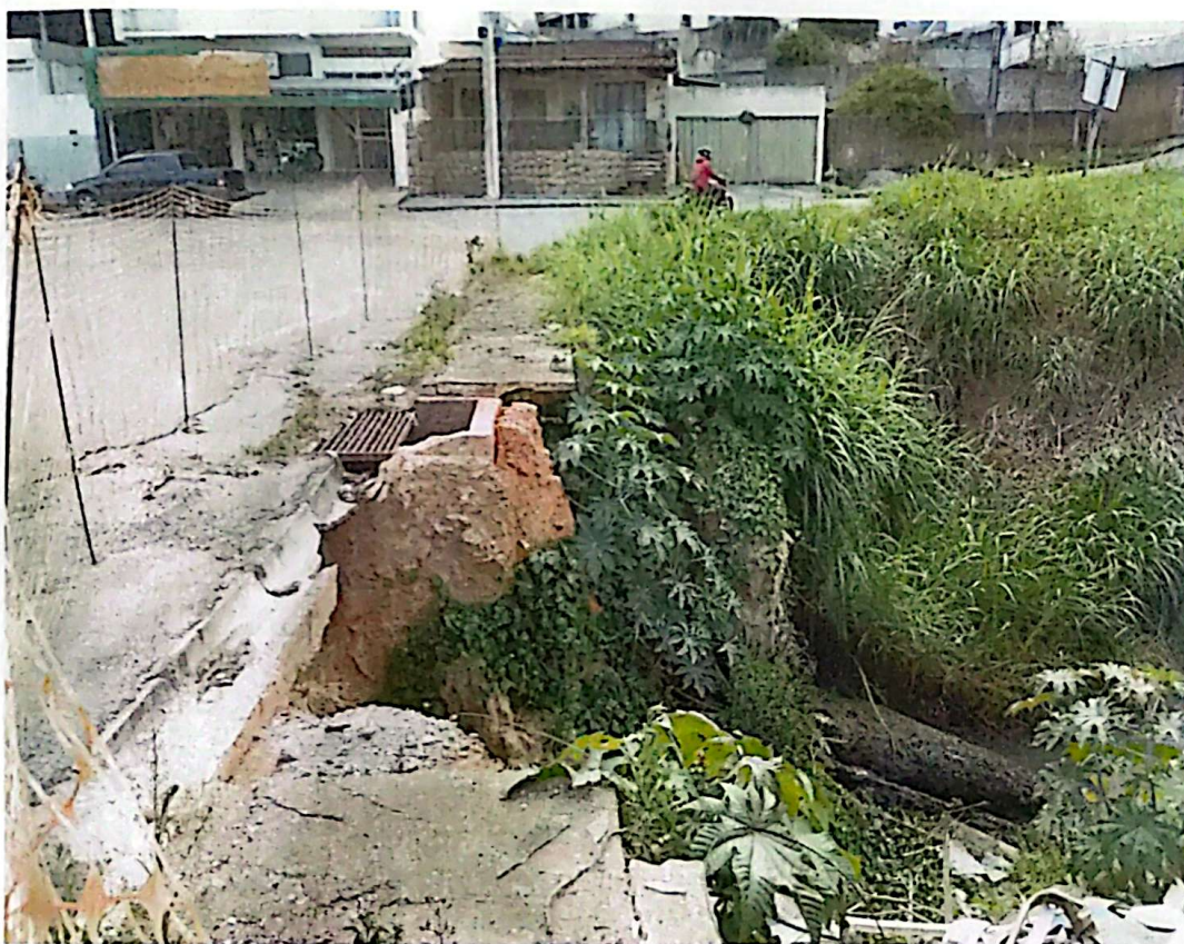
FOTO 04 – Desabamento de parte da calçada da Rua Joaquim Ferreira de Resende com evolução no processo erosivo com parte da canaleta de concreto danificada.
